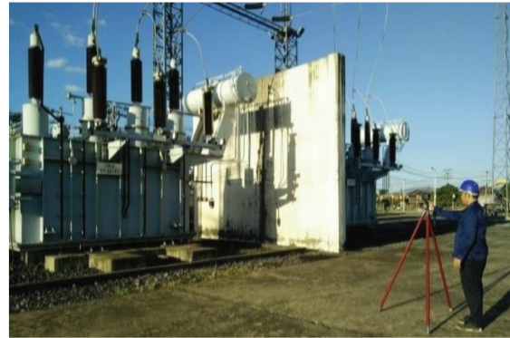
รูปที่ 2 การถ่ายภาพความร้อนหม้อแปลงไฟฟ้ากำลัง
