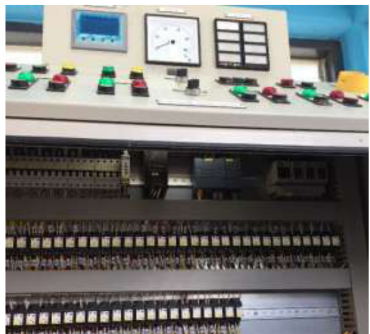
รูปที่ 3 แผงควบคุมไฟฟ้าและตัวควบคุมเชิงตรรกะที่สามารถโปรแกรมได้
