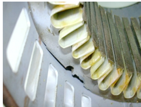
รูปที่ 3 การรองฉนวนไมก้าในร่องสลิตบนสเตเตอร์ของเครื่องกำเนิดไฟฟ้า
