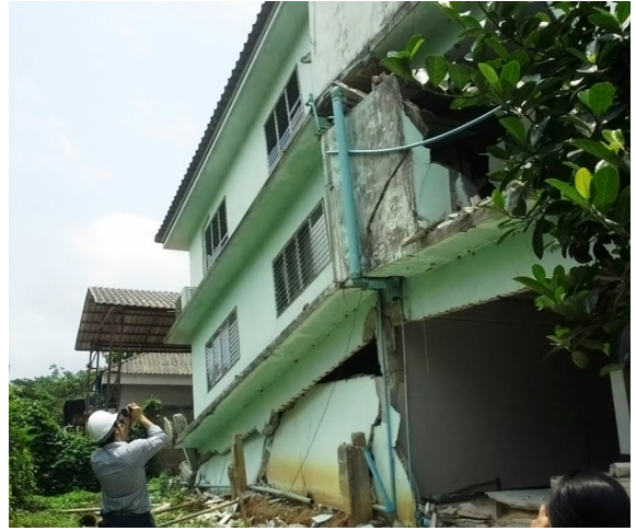
รูปที่ 1 สภาพอาคารเรียนเสียหายเนื่องจากแผ่นดินไหว [2]
