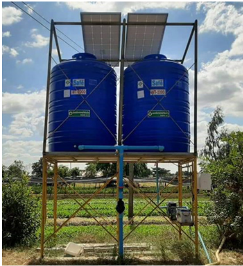
รูปที่ 1 ระบบสูบน้ำพลังงานแสงอาทิตย์
