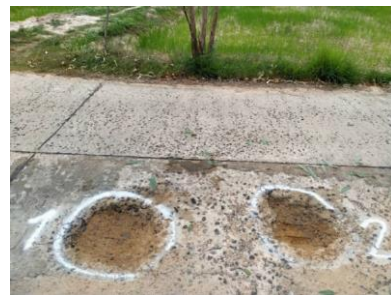
รูปที่ 7 ผิวการจราจรที่จะทำการซ่อมแซม
