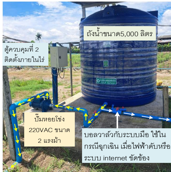
รูปที่ 2 การติดตั้งถังน้ำ ตู้ควบคุม ปั๊มน้ำแบบหอยโข่งขนาด 2 Hp เพื่อสูบน้ำออกจากถังไปยังกองปุ๋ยหมัก
