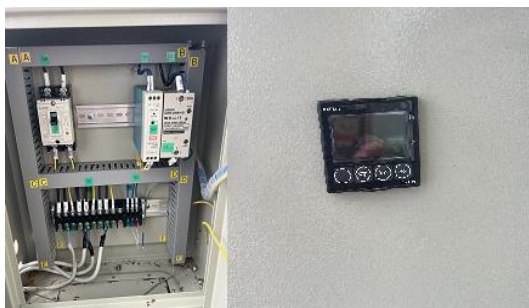
รูปที่ 8 ติดตั้งตัวควบคุมอุณหภูมิ โซลิดสเตตรีเลย์และ เบรกเกอร์ภายในตู้ไฟ
