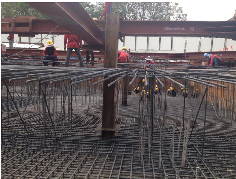
รูปที่ 4 การทำงานเหล็กเสริมในฐานรากคอนกรีต
