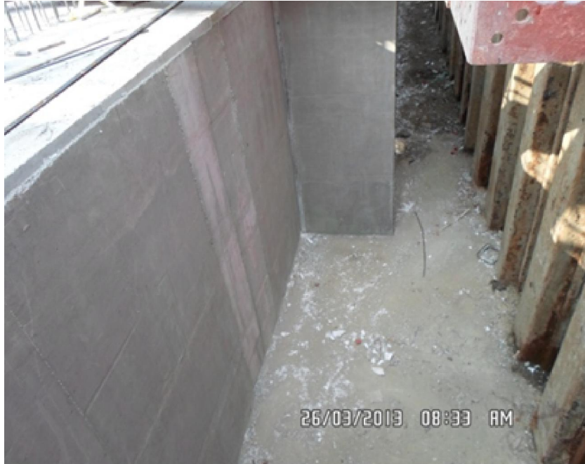
รูปที่ 19 สภาพพื้นผิวด้านข้างของฐานรากคอนกรีต
