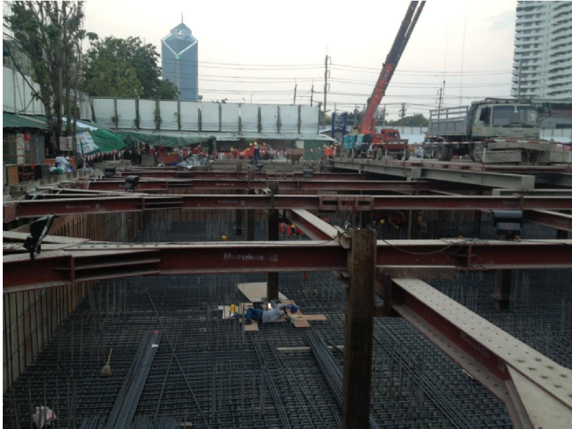
รูปที่ 3 โครงสร้างระบบค้ำยันเข็มพืด (Sheet pile bracing system)
